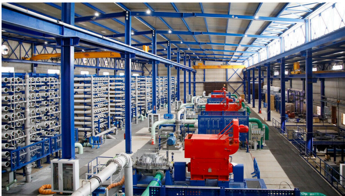
Planta desalinizadora Mar de Alborán, en la costa de Almería. | Marian León (EP)
